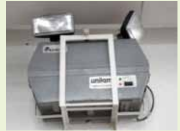
Figura 61 Iluminação de emergência
