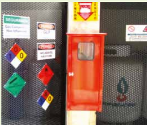
Figura 65 Cilindros de GLP
