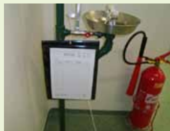
Figura 25 Chuveiro e lava-olhos de emergência
