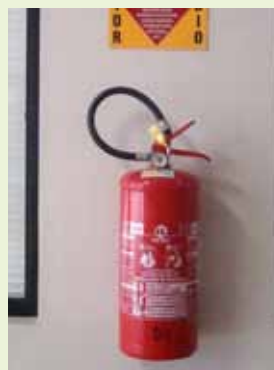
Figura 51 Extintor de pó químico seco
