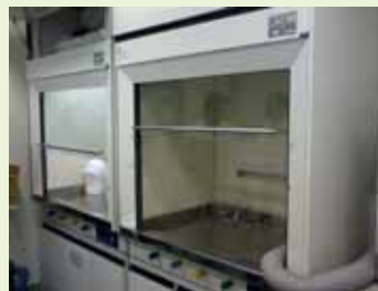
Figura 26 Capela de exaustão
