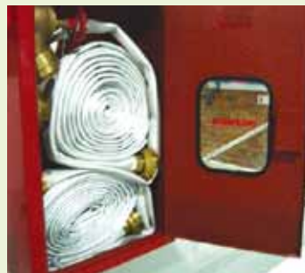
Figura 55 Hidrante de parede
