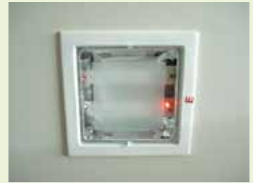
Figura 62 Iluminação de emergência
