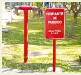
Figura 54 Hidrante de passeio
