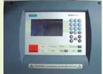
Figura 57 Central de alarmes
